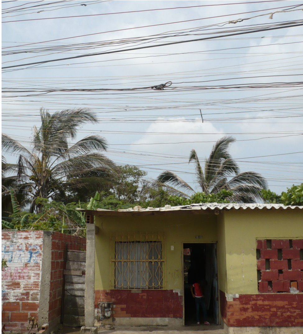
Une fourniture d'électricité chaotique dans les quartiers défavorisés
